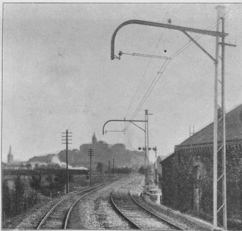
Abbildung 3b. Mast-Anordnung auf einer Seite in den Krümmungen.
