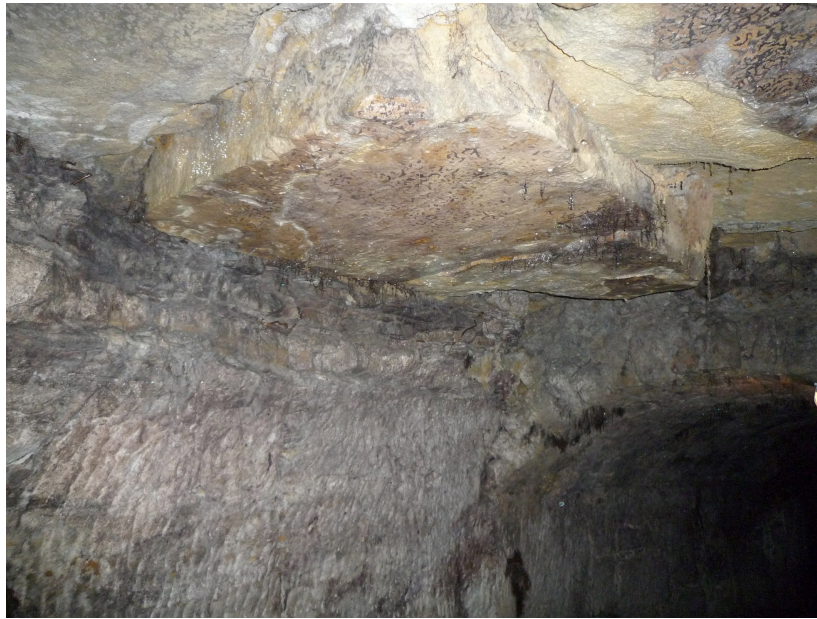
Weiß-Tauben-Keller Südgang. Absturzstelle
