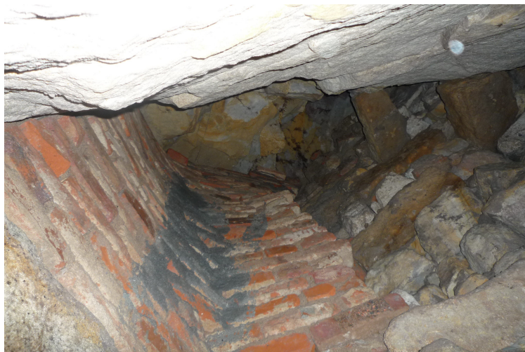
Einsturzstelle im Bauernkeller
