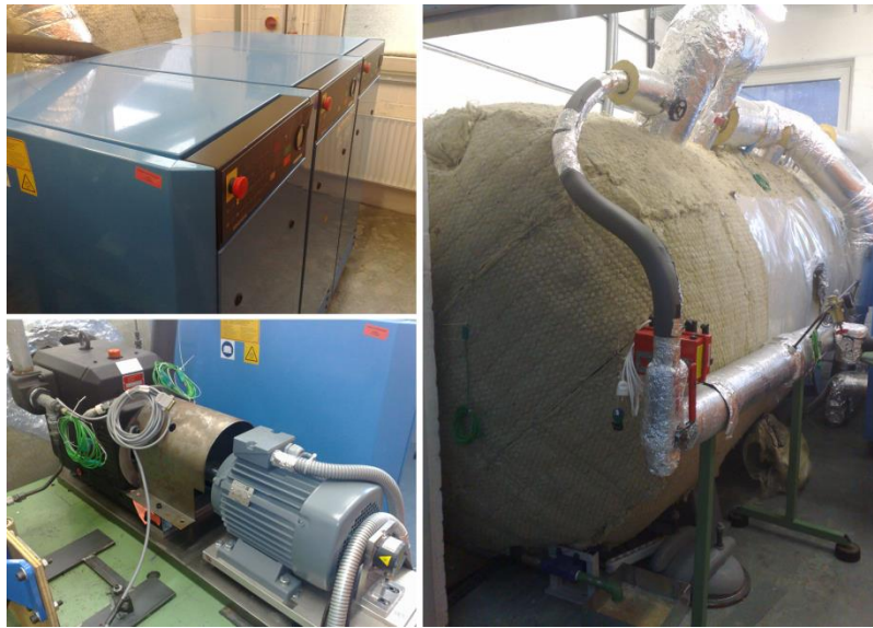
Abb. 3-4 ACAES Versuchsanlage an der TU-Clausthal, li. o. Kompressor, li. u. Hakenzahn-Turbine, re. Isolierter Drucktank
