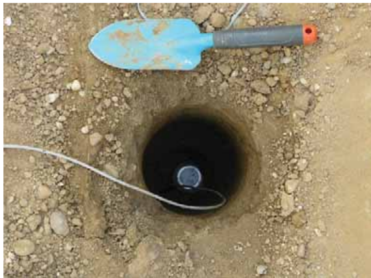
Abb. 3.37: Durchbohrte Deckschicht mit installiertem Porenwasserdruckgeber.
