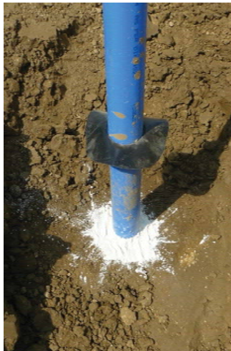
Abb. 3.32: Manschettenring zur Sickerwegverlängerung am Pegelrohr.
