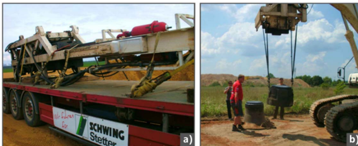
Abb. 28: Transport des Impulsverdichters in zwei Teilen [46] a) Schlaghammer mit Fallgewicht auf einem Tieflader geladen, b) Montage der Schlaghaube auf der Baustelle
