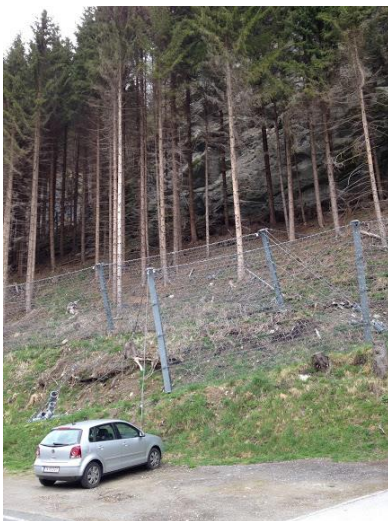
Abbildung 24: Steinschlagnetze in der Gemeinde Muhr (Quelle: Eigenes Foto, 2015).
