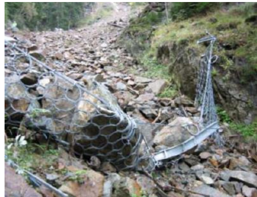
Abbildung 23: Zerstörtes Steinschlagnetz (Quelle: WLW/HÜBL et. al. 2011)
