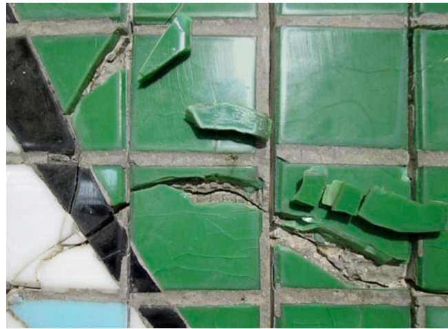
112.2 Vorderseite eines Wandbildsegments mit Brüchen und Fehlstellen über den Rissen im Setzmörtel, Unterkamlach, Frühjahr 2019
