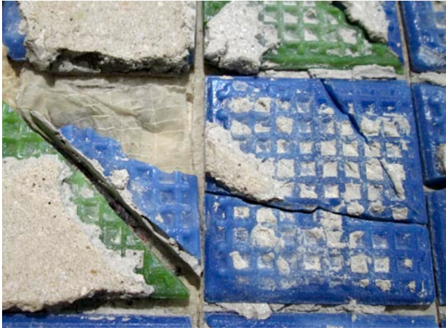
110.1 Schadensbild auf der Wandbildrückseite nach Abschneiden des Ausgleichsmörtels, Unterkammlach, Frühjahr 2019
