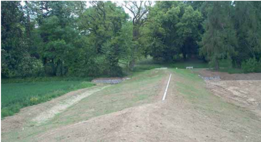
Abbildung 15: Durch Bodenverfestigung überströmbarer Damm am Beispiel des RRB Hemmingen.
