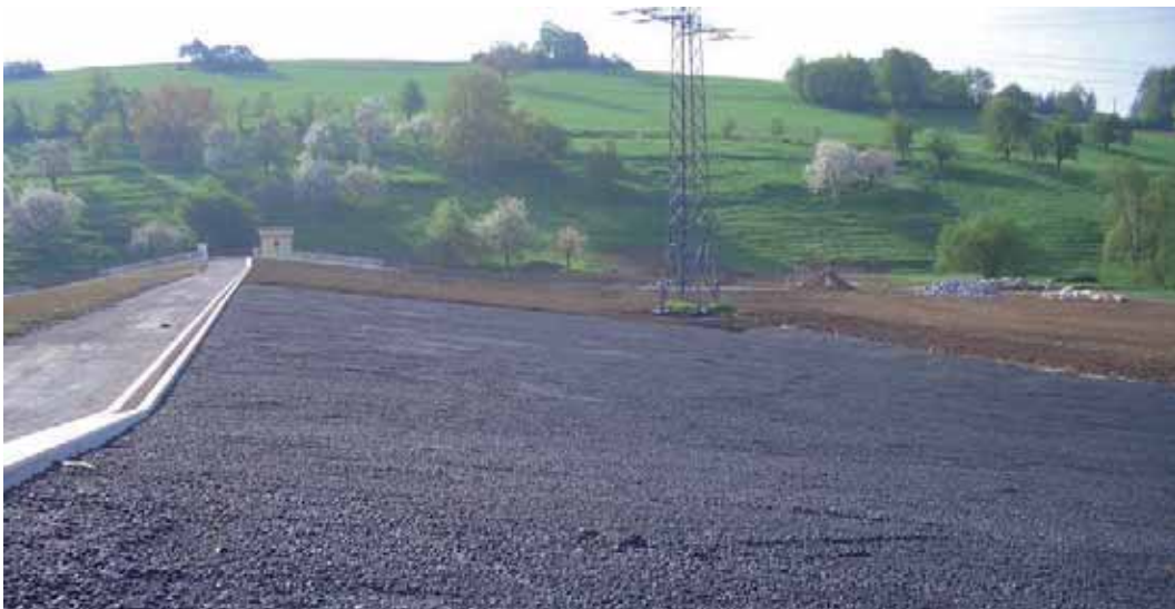
Abbildung 11: Mastix-Schotter-Deckwerk am HRB Mönchzell bei Meckesheim des Zweckverbands Hochwasserschutz Einzugsbereich Elsenz-Schwarzbach vor der Begrünung.
