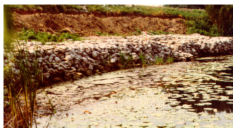
Abb. 30 Rutschung und Böschungssicherung [RPDA]
