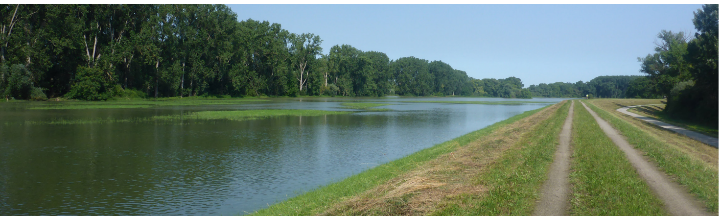
Abb. 7 Deich beim Hochwasser im Juli 2021 [RPDA]
