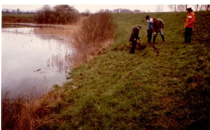
Abb. 29 Risse in der Deichböschung [RPDA]
