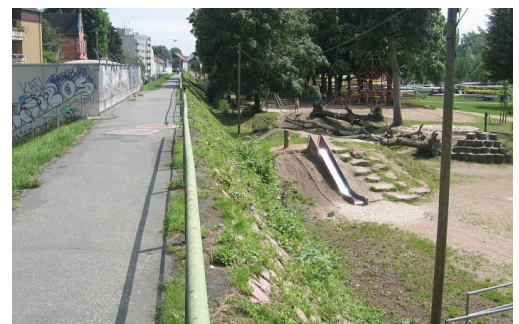
Abb. 67 Zu nahe Bebauung am Deich verhindert die Kontrolle und erhöht bei Einbauten im Untergrund die Durchsickerung. Sickerwasseraustritte werden gar nicht oder zu spät erkannt. Die Deichverteidigung wird erschwert. [RPDA]
