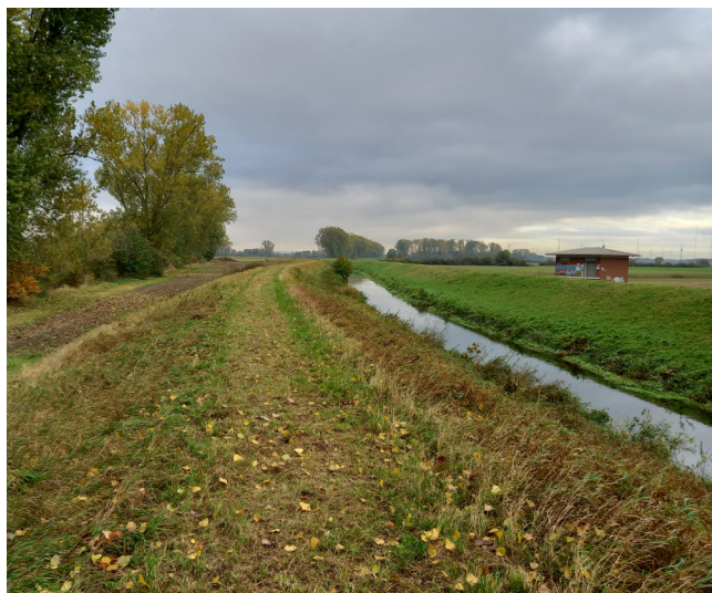
Abb.15 Nicht ausgebauter Deich bei Einhausen [RPDA]
