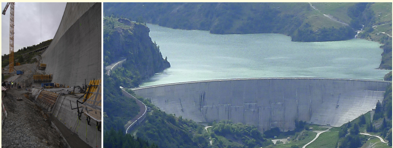
Bild 8. Erdbebenertüchtigung der Bogenstaumauer Les Toules im Wallis durch massiven Beton-Stützkörper auf der linken Talseiten (links) und mit den fertiggestellten Stützkörpern auf beiden Talseiten (rechts).
