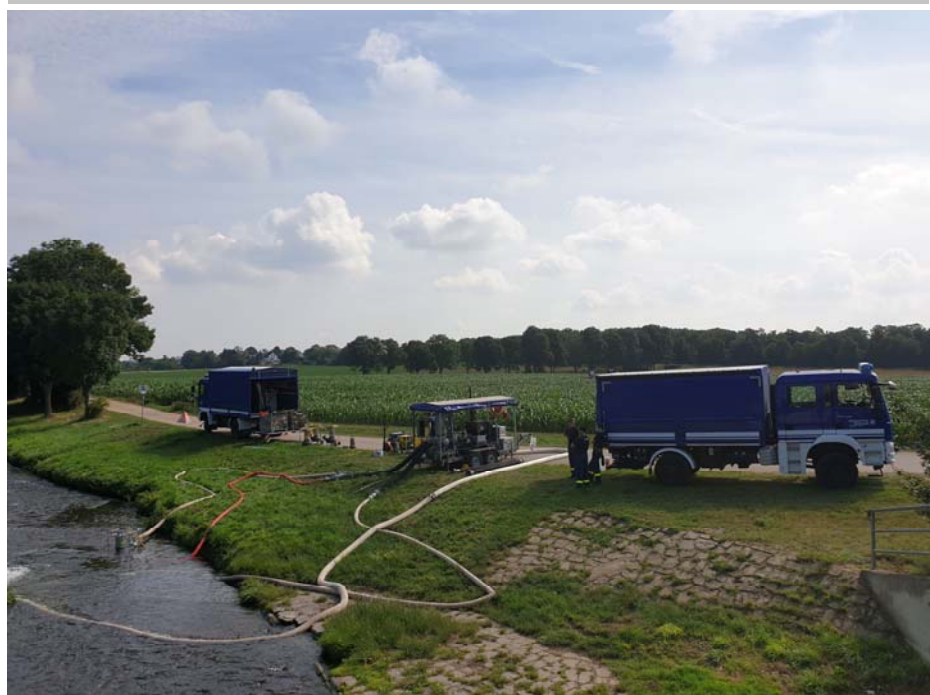
Die WP an der Erft in Horchheim—mit Hannibal und E-Pumpen
