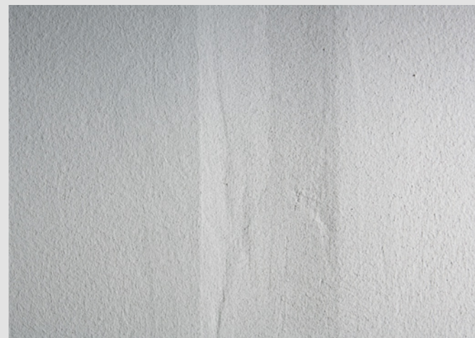
Vertieft gespachtelte Fuge bei starkem Streiflicht
