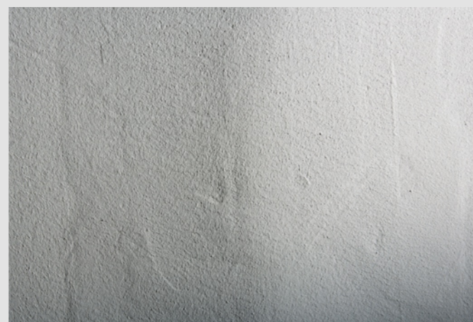
Erhöht gespachtelte Fuge bei viel Streiflicht
