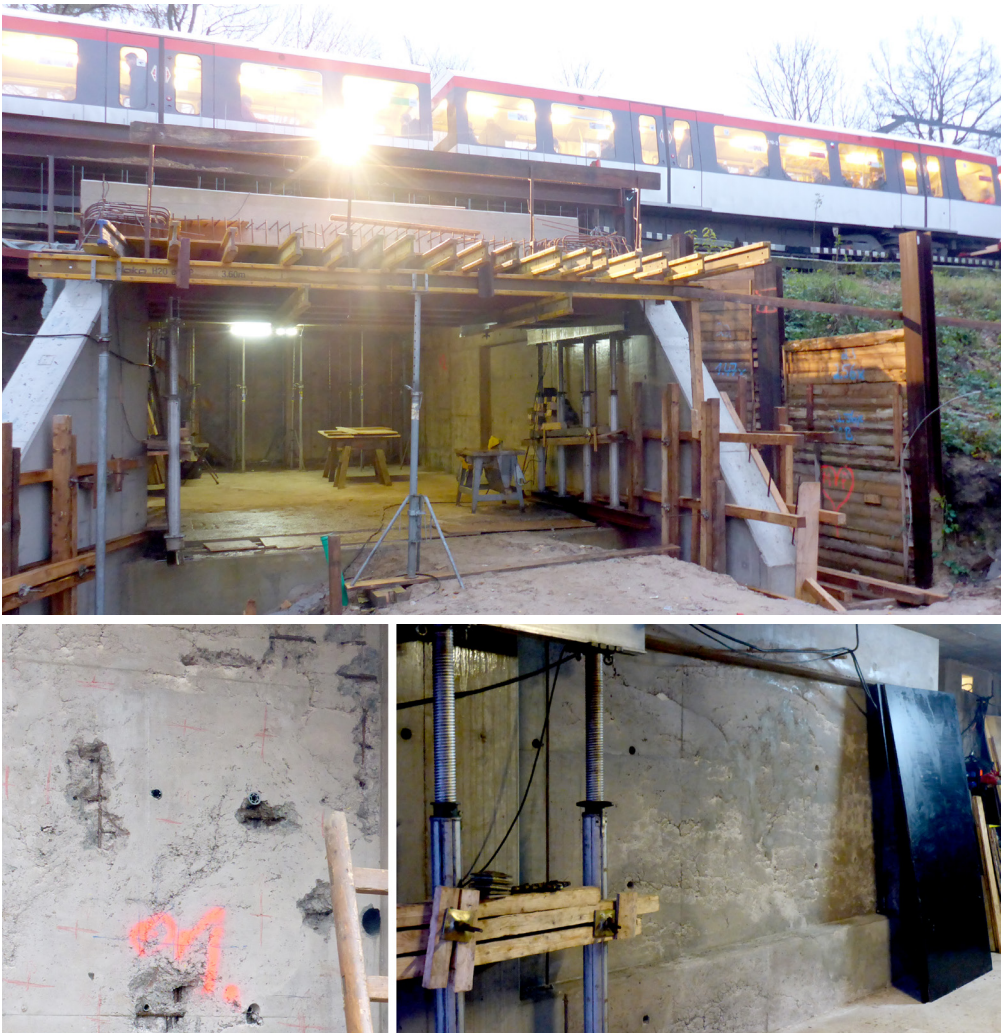
Bild 2: Übersichtsfoto der Baustelle und exemplarische Detailfotos der visuell erkennbaren Schäden
