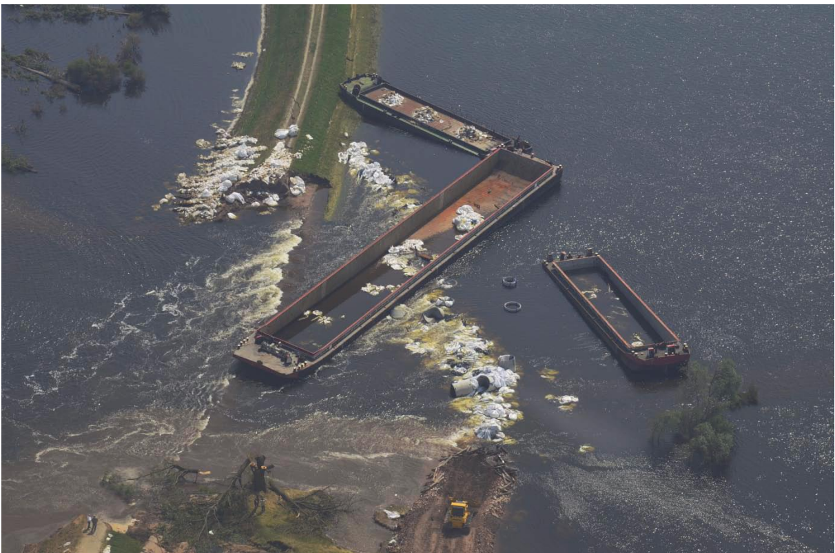
Abbildung 25: Erfolgreich geschlossener Deichbruch bei Fischbeck [LHW]
