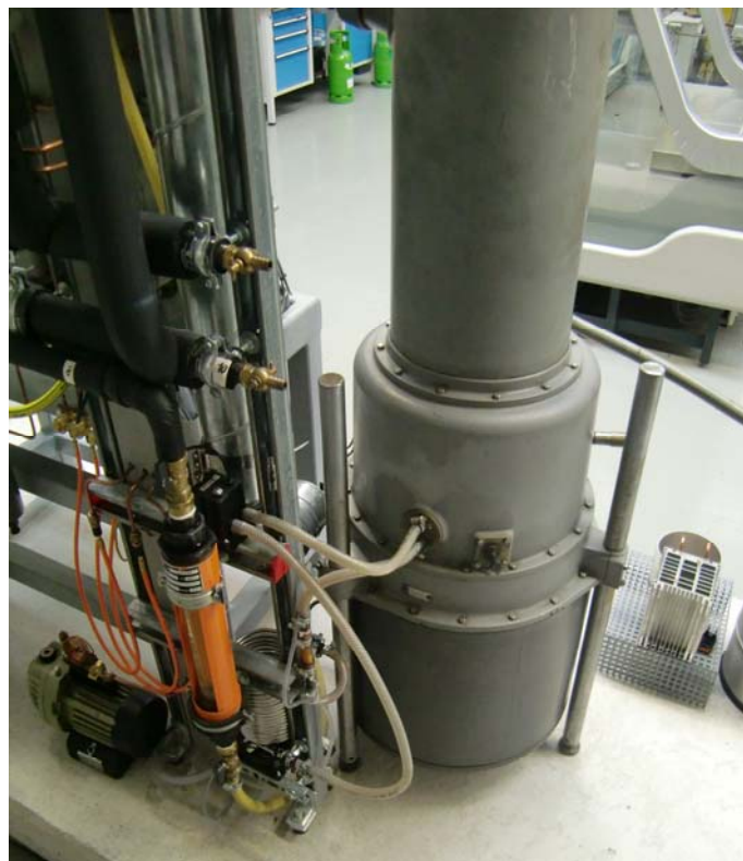
Abbildung 5–31: Kolonne mit Wasserkreis der Dampfblasenpumpe
