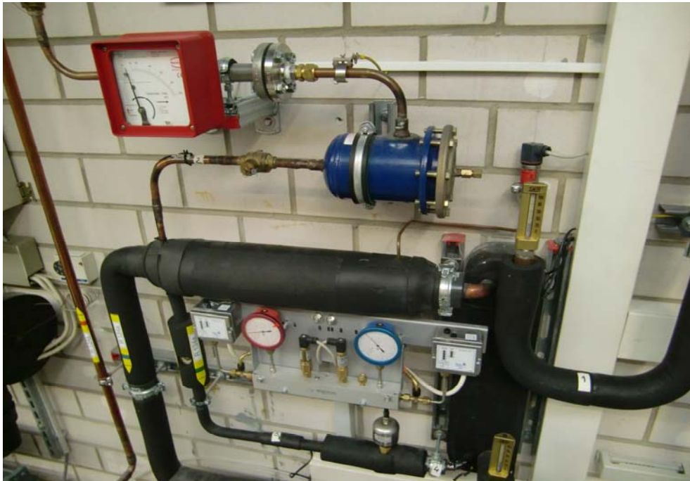
Abbildung 5–24: Verdampfer, innerer Wärmeübertrager, Instrumententafel und Massestromzähler
