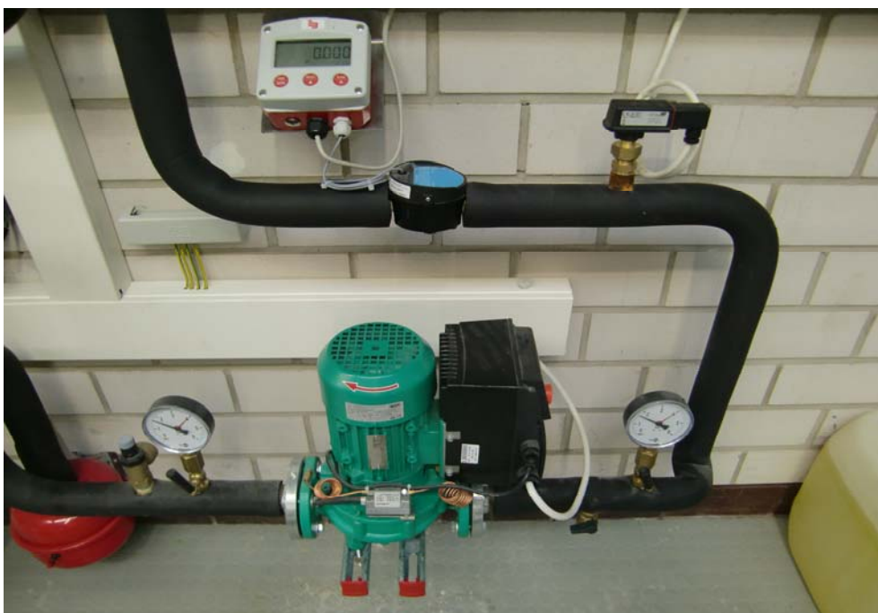
Abbildung 5–23: Wasserpumpe mit Massestromzähler
