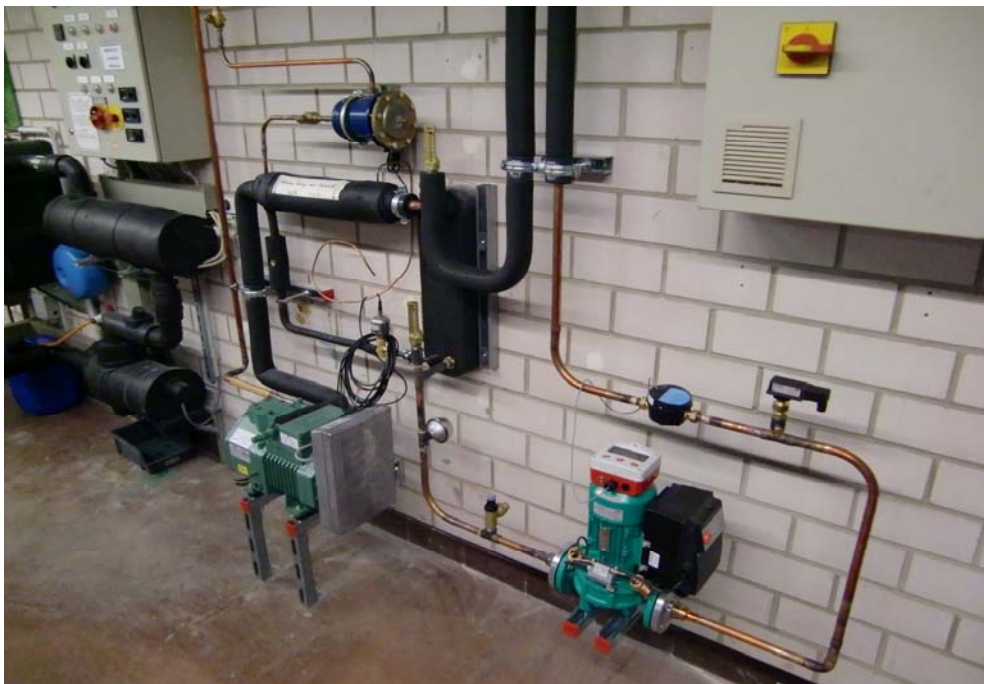
Abbildung 5-7: Kaltwassersatz im Aufbau
