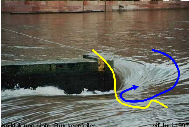
Kolkbildung hinter Brückenpfeiler vif Juni 1997
