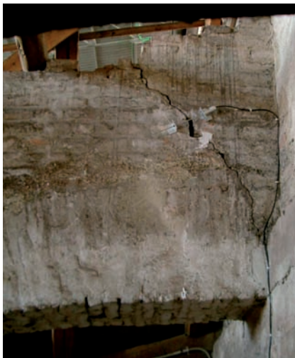
Abb. 13: Strebebogen der Nordseite, typischer, nach oben V-förmig aufgehender Riss am Ansatz des Bogens an die Hochschiffmauer
