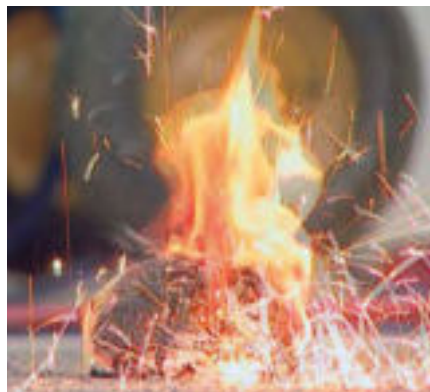
Hohe Zündenergie: Funkenflug bei Brennschneidarbeiten
