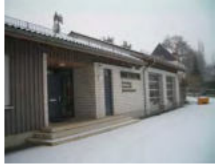
Treppen als Zugang zu Feuerwehrhäusern sind immer Gefahrstellen – auch wenn sie den baurechtlichen Anforderungen genügen.
