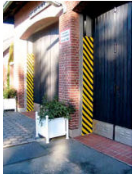
Gelb-schwarze Gefahrenkennzeichnung der Tordurchfahrt nach außen
