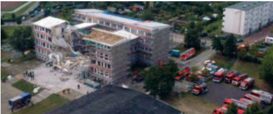
Einsturz eines Schulgebäudes durch unsachgemäße Bauarbeiten
