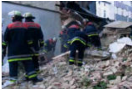
Sturzgefahr – die Aufräumarbeiten werden durch mangelnde Trittsicherheit behindert.
