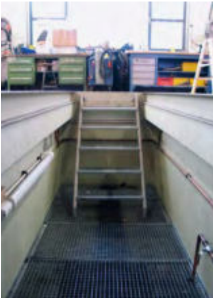
Beleuchtung in der Arbeitsgrube – die eingebauten Leuchten entsprechen der Schutzart IP 54.
