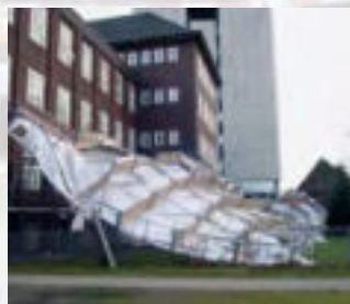
Gerüstumsturz durch Sturmeinwirkung
