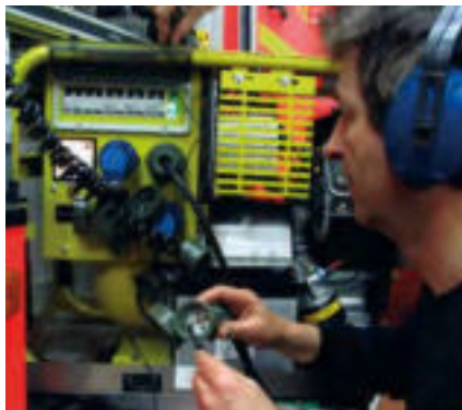
Überprüfung der Schutzmaßnahme eines tragbaren Stromerzeugers
