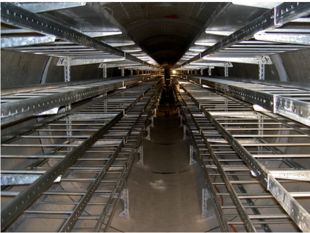
Innenleben des 30 kV E-Kollektors DN2600 Bild: PORR
