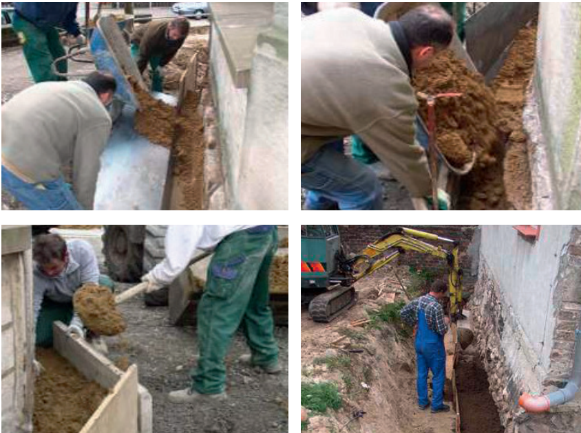
Mit Hilfe eines Baggers lässt sich die DERNOTON®-Fertigmischung BA leicht zwischen Mauerwerk und Trennstreifen einbringen.
