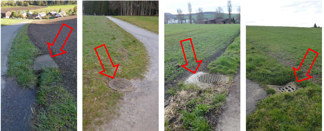
Schächte mit Entwässerungsfunktion von Feldwegen und Strassen sind landseitig durch einen Pufferstreifen mit bewachsenem Grünland von mindestens 0,5 m ab Schachtrand zu schützen (bei allen vier Beispielen ist Handlungsbedarf gegeben (siehe Pfeil →)).
