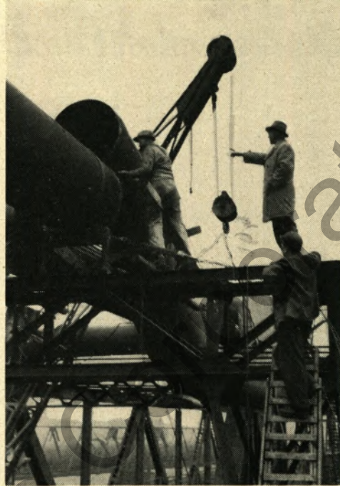
Hier wird Millimeterarbeit geleistet, denn auf beiden Seiten muß der Rohrbogen gleichzeitig eingepaßt werden. In diesem Augenblick kommt es auf ein gutes Zusammenspiel aller Mitarbeiter mit dem Kranführer an.
