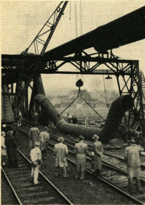
Der entscheidende Augenblick ist gekommen: Ein Schienenkran hebt den fünf Tonnen schweren neuen Rohrbogen in die soeben geschaffene Lücke in der Restgasleitung, die für einige Stunden außer Betrieb ist.
