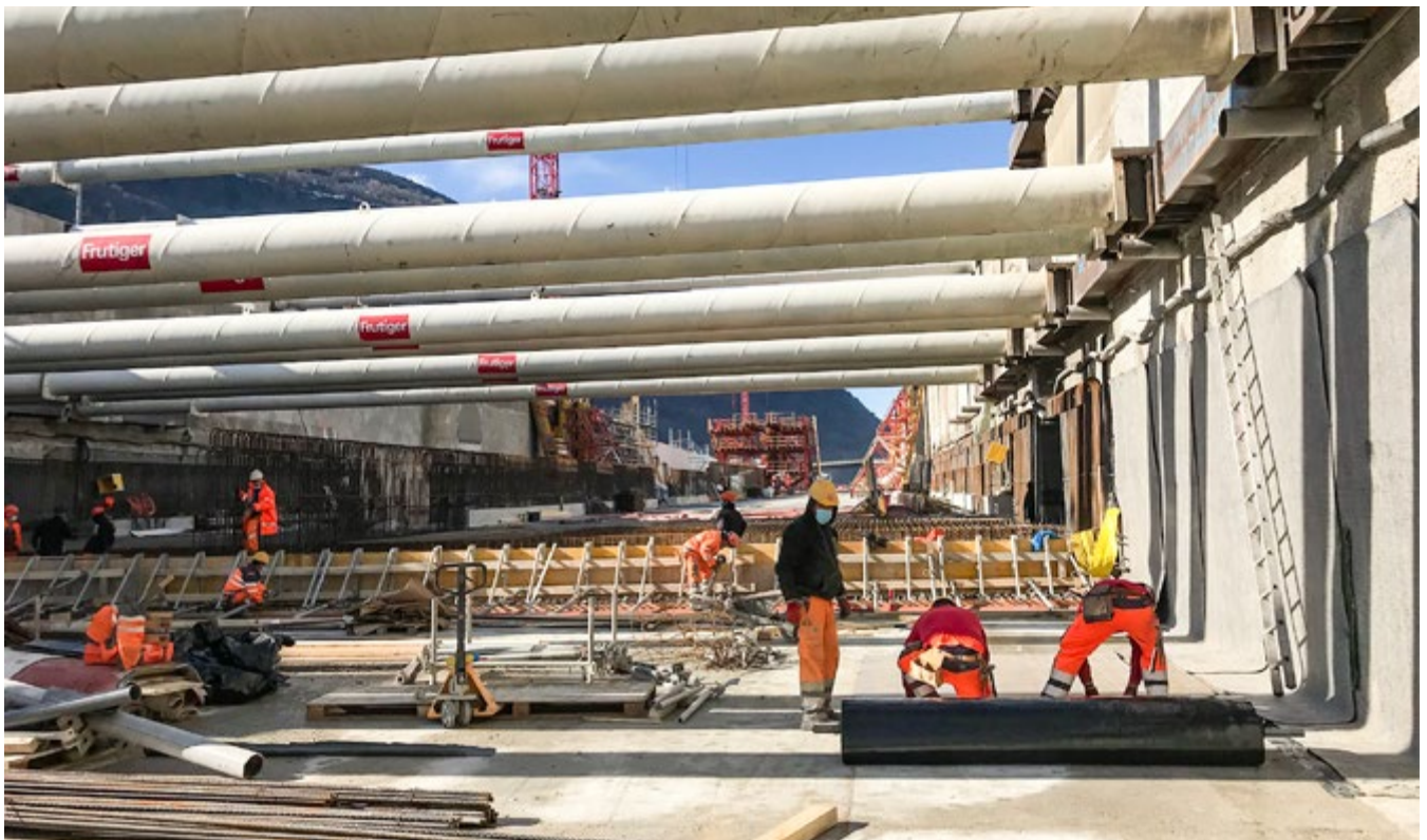
Auf der A9 im Kanton Wallis bei Raron: Standards müssen auch bei diesen Arbeiten am gedeckten Einschnitt (900 m Länge) eingehalten werden.
