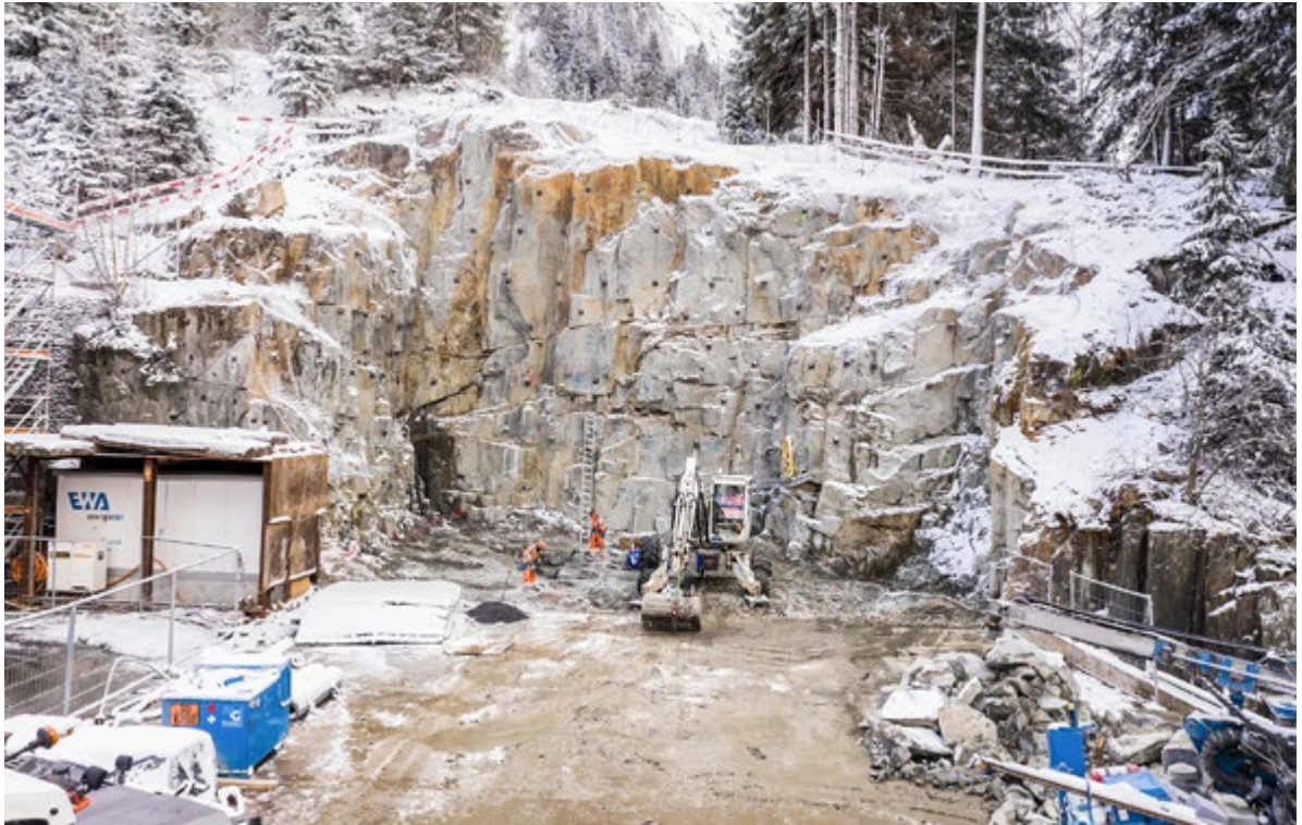
Vorarbeiten für die Umlegung des Service- und Infrastrukturstollens (SISTo) am Nord-Portal bei Göschenen.
