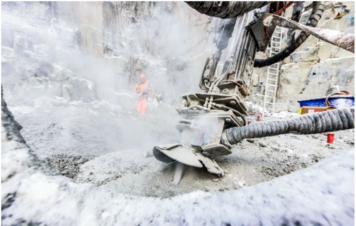
Am Nord-Portal in Göschenen werden Bohrlöcher für Sprengarbeiten in den Fels getrieben.
