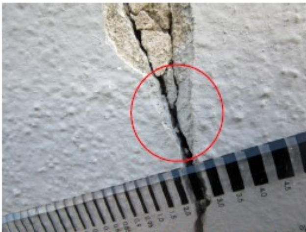
Dieser Riss muss schon vor der Anstrichausbesserung bestanden haben, da der Riss selbst auch partiell Farbe aufweist (Westfassade EG).
