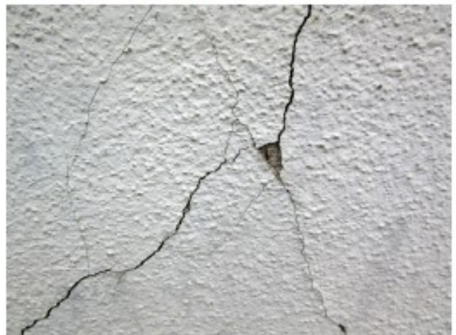
An Positionen, wo Risse sich kreuzen, sind auch bereits erste, kleinflächige Fehlstellen zu beobachten.
