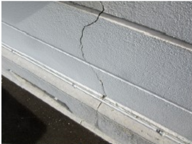
Riss an der Westfassade Sockel
