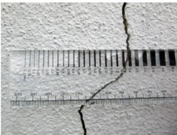
Riss mit einer Breite von 2.0 mm (Westfassade EG)
