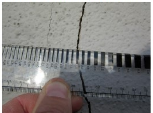
Riss mit einer Breite von 1.5 mm (Westfassade EG)
