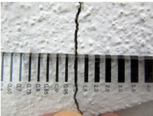
Riss mit einer Breite von 1.0 mm (Westfassade EG)
