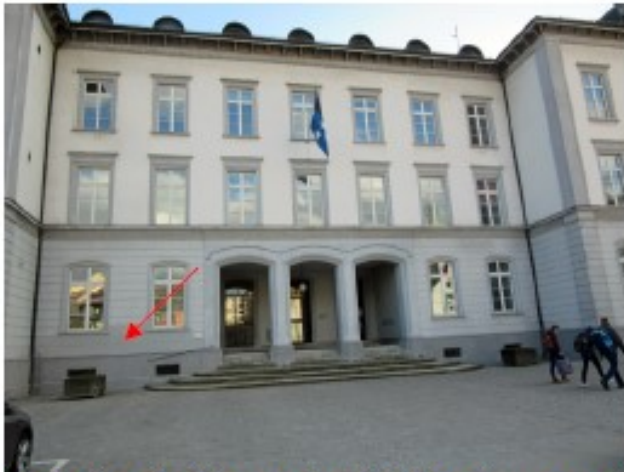
An einzelnen Positionen wurden Anstrichausbesserungen ausgeführt (siehe Pfeil, Nordfassade).
