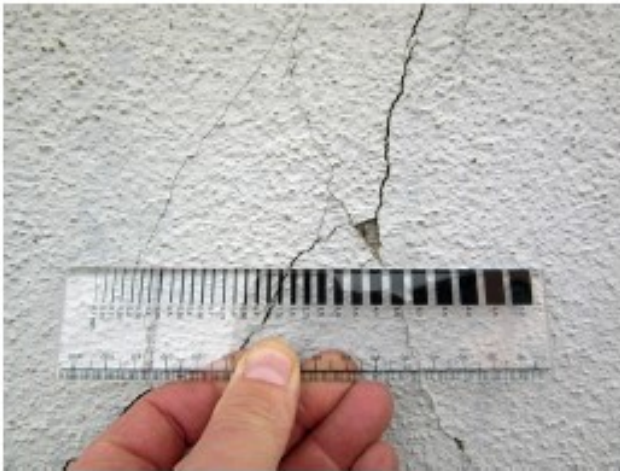
mehrere Risse in verschiedenen Breiten (Westfassade)
