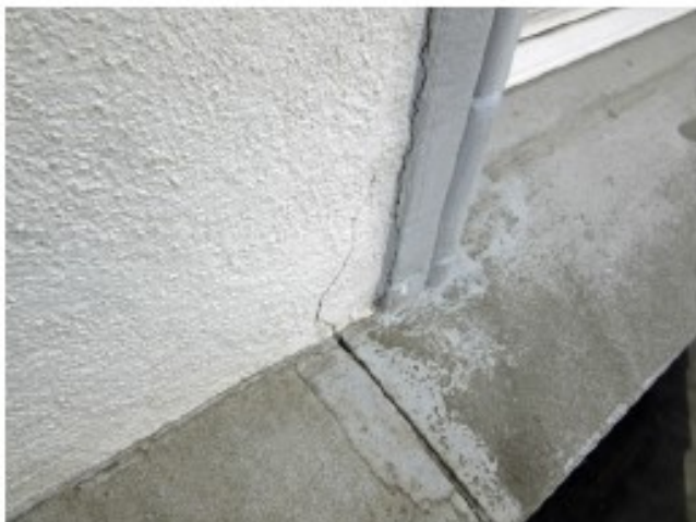
Oft setzen sich Risse dort fort, wo auch ein Materialwechsel vorhanden ist.
