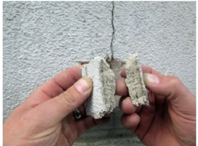
Riss an der Ostfassade EG mit leichten Verschmutzungsspuren an den Rändern. (Probeentnahmestelle 5)
