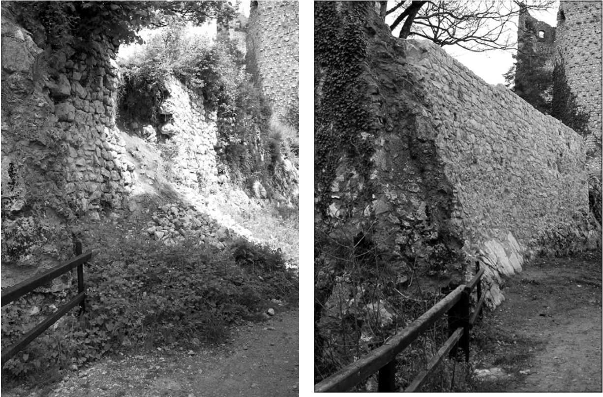
Schloss Pfeffingen 2006: Links die partiell eingestürzte Zwingermauer, rechts die gleiche Partie, die im Zuge einer Notmassnahme nach modernsten Erkenntnissen der Denkmalpflege saniert wurde.
