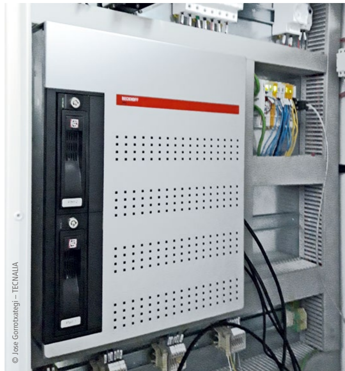
Ein Schaltschrank-Industrie-PC C6650 übernimmt die zentrale Steuerung aller Achsen und die Positionierung des Seilroboters anhand diverser nautischer Sensorik.
