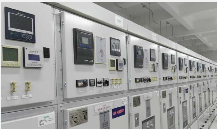
Die Energie des Rechenzentrums wird über mehr als 50 Schaltanlagenkreise im Medium- und Niederspannungsbereich unterverteilt.
