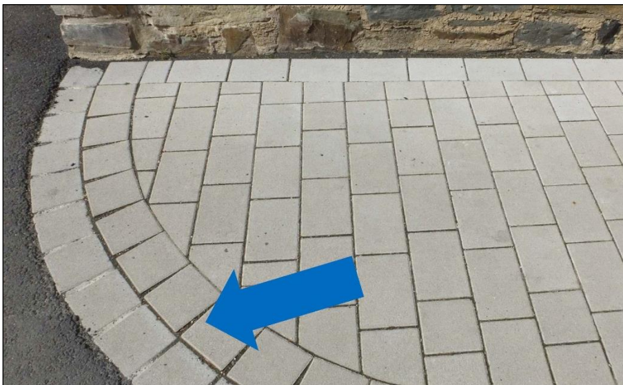
Bild 25: Keilfuge, die im Anschlussbereich der Pflasterdecke an eine Rundung entsteht (Foto: SLG)
