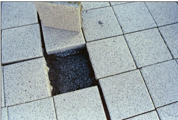
Bild 16: Verschiebungen der Pflastersteine nach dem Abwandern des Fugenmaterials in die viel zu grobe (hohlraumreiche) Bettung (Foto: SLG)
