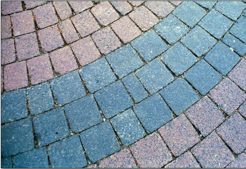
Bild 26: Keilfugen, die im Verlauf von Pflasterungen in Kurvenbereichen entstehen (Foto: SLG)
