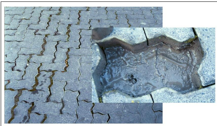
Bild 15: Massiver Schaden an einer Pflasterbefestigung durch zerriebenes Bettungsmaterial, was eine vollständig abgedichtete Bettung nach sich zog (Fotos: SLG)
