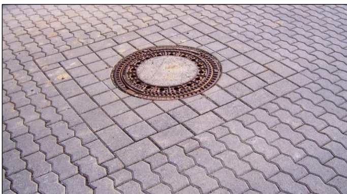
Bild 31: Fachlich und handwerklich gelungener Anschluss einer Pflasterdecke aus Verbundsteinen an einen Schachtdeckel mit Hilfe von Rechteck- und Sonderformsteinen (Foto: SLG)
