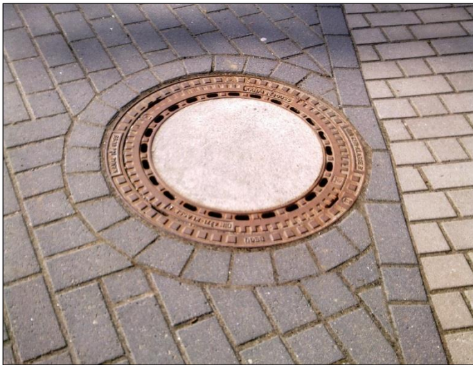
Bild 30: Fachlich und handwerklich weitgehender Anschluss einer Pflasterdecke aus Rechtecksteinen an einen Schachtdeckel mit Hilfe von Passsteinen (Foto: SLG)
