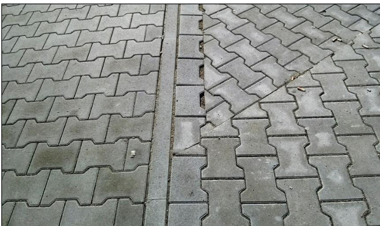
Bild 33: Für derartige Anschlussbereiche können die Regelwerke des Straßenbaus keine befriedigende fachliche Lösung anbieten; sie sind individuell und einvernehmlich zu gestalten (Foto: SLG)
