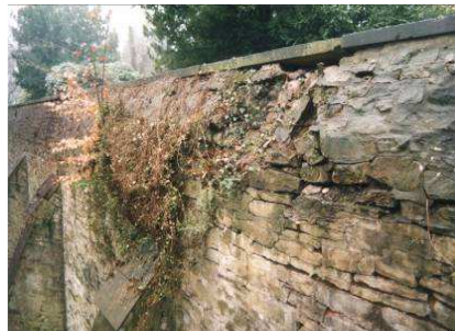
Ausbrüche im Kronenbereich
