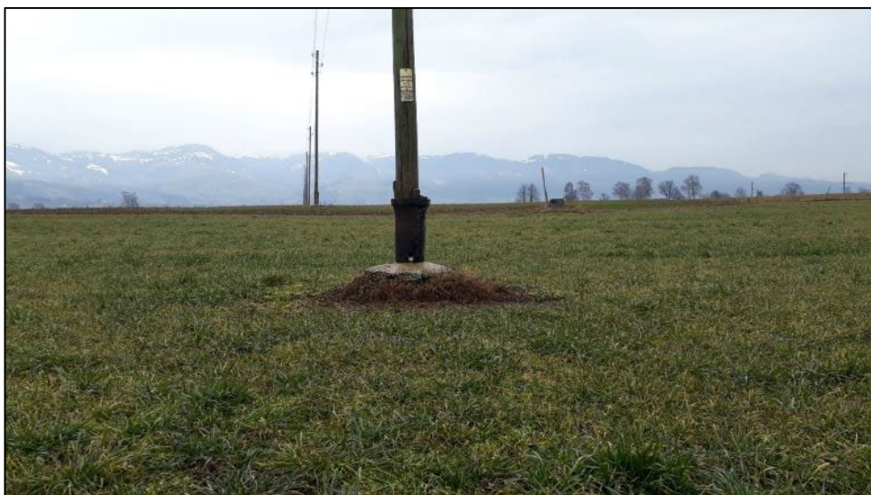
Abbildung 48: Stromleitung im Gebiet Wegscheid westlich der Eisenbahnlinie Altstätten-Oberriet. Gut sichtbar ist die Sackung des Terrains am Fundament im Vordergrund und dem Dohlendeckel rechts hinten. Hier ist das organische Substrat 75 cm mit alluvialem Ton überdeckt, die Sackung ist dadurch gebremst, aber nicht gestoppt. Im Hintergrund ist ein ehemaliger Bachlauf zu sehen, der 2 m über das vordergründige Terrain hinausragt. Die Masten auf dem Rücken zeigen keine Sackungsspuren, hier ist das organische Substrat bereits mit mehr als 2 Meter mineralisch überdeckt.
