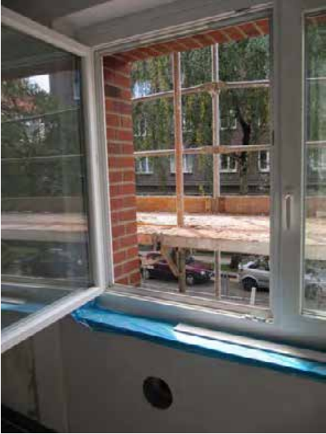
[1] Fenster in der Küche, sowie Außenwand Luftdurchlass unterhalb des Fensters
