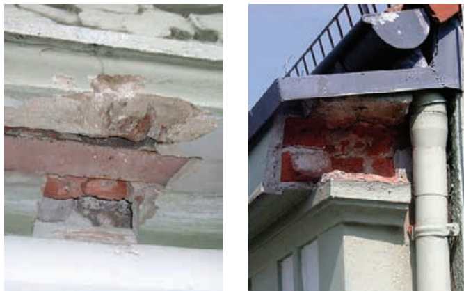
Bild 2. Wärmebrückendetails: Fenstersturz (links) und Traufgesims (rechts) Fig. 2. Details of thermal bridges: lintel (left) and eaves cornice (right)
