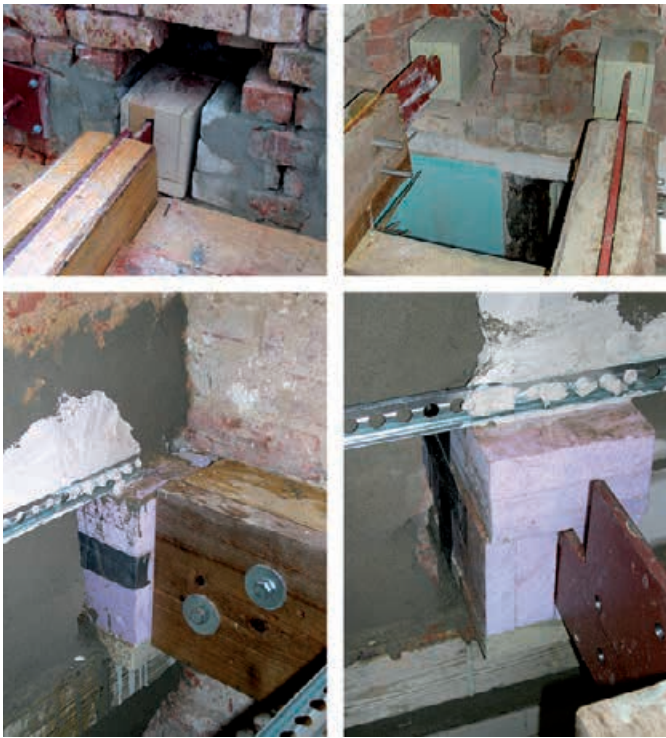
Bild 13. Arbeitsschritte bei der Erneuerung des Balkenauf-lagers: Stahlschwert und Dämmstofffertigteil eingebaut (oben), Außenmauerwerk beigemauert und vergossen (unten links), Stahlschwert mit Kanthölzern verdübelt (unten rechts) Fig. 13. Individual steps for renewing the beam support: steel plate and prefabricated insulation component after installation (top), exterior masonry made good and grouted (bottom left), steel plate connected to squared timbers (bottom right)
