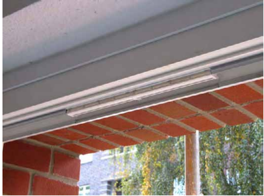
[2] atmosphärische Lüftungsclappe im Fenster
