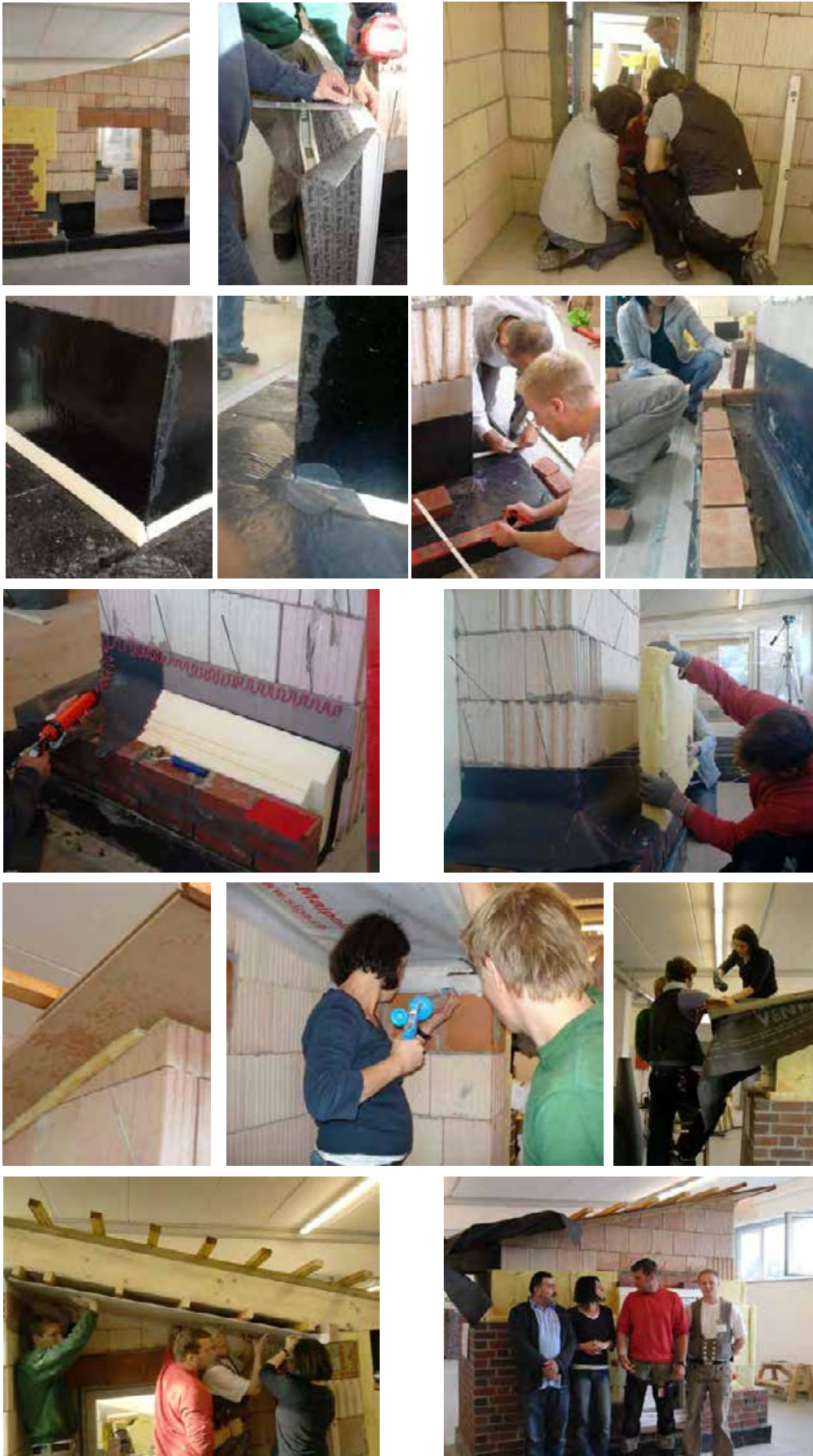
Praktische Arbeit Gruppe 1: Zweischaliges Mauerwerk mit Kerndämmung Fotos: Mükerrerem Aksoy, Sönke Damrau, Claudia Leufer, Britta Stein, AZB Hamburg
