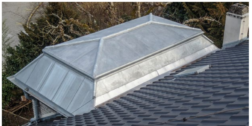
Ein neues Dach mit Wulsten und liegenden Falzen, wie das historische Original
