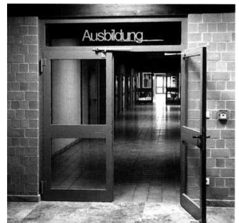
Bild 5.7 Gefährliches Aufkeilen einer Brandschutztür
