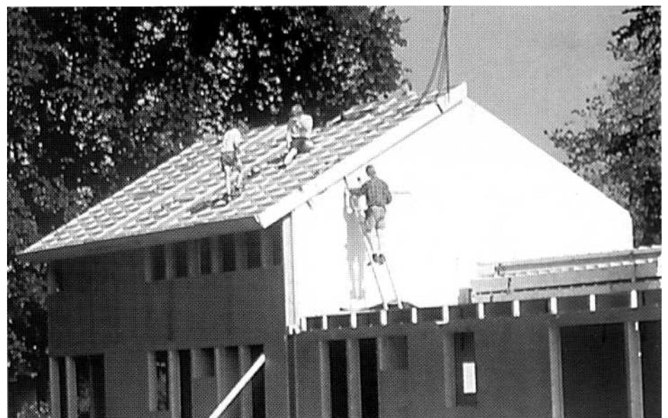
Bild 5.3 Montage einer Trennwand, Doppelhaus in Holzrahmenbauweise im Wohnpark Engter (Werkfoto: Glunz AG)
