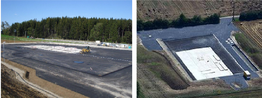
Abb. 6.9: Bohrplätze mit Fundament für den Bohrturm (Geothermische Kraftwerksgesellschaft Traunreut mbH 2012, ExxonMobil Production Deutschland GmbH 2011a)
