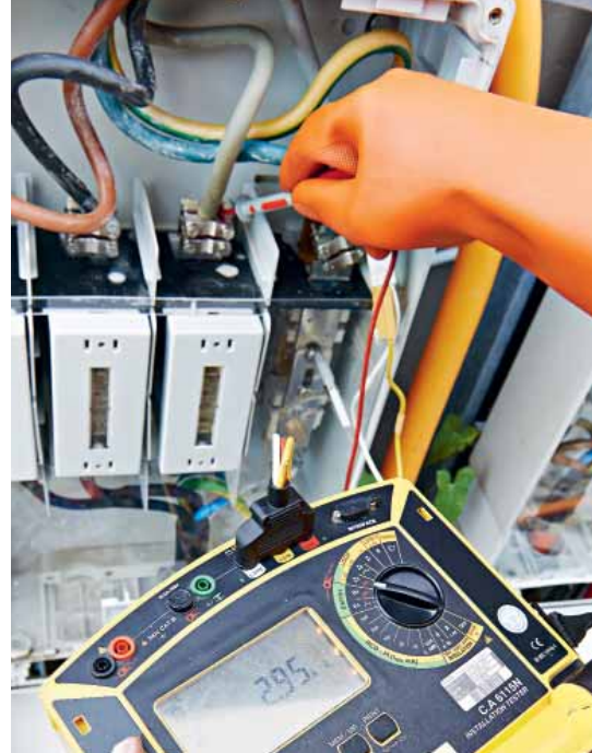
Erst nachdem die unabhängige Abnahmeprüfung erfolgt ist, kann die provisorische Installation in Betrieb genommen werden.
