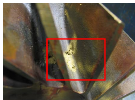
c) Schadensbild Schaufelgrund
