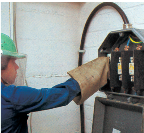
Schutzmaßnahmen beim Einsetzen und Herausnehmen von NH-Sicherungseinsätzen
