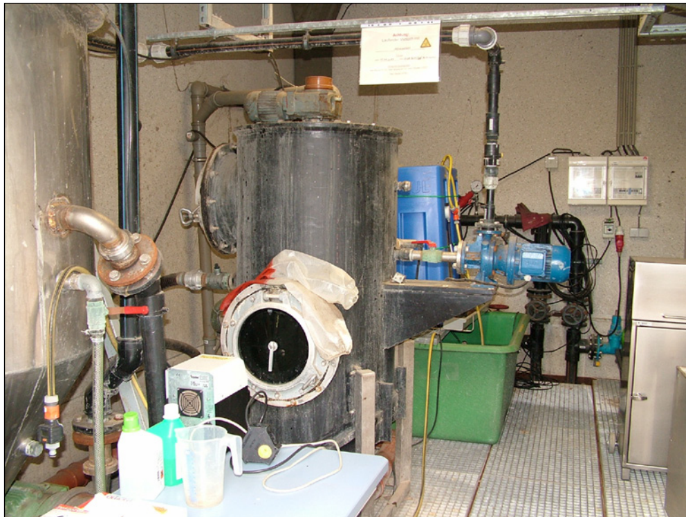
Abbildung 9) Abwassersiebanlage auf dem UBA-Versuchsfeld am Standort Berlin-Marienfelde. Bildmitte: Trommelsiebanlage; Hintergrund: Abwasserzuleitungen, PAUL C und PAUL D (Quelle: UBA, GRUNERT).
