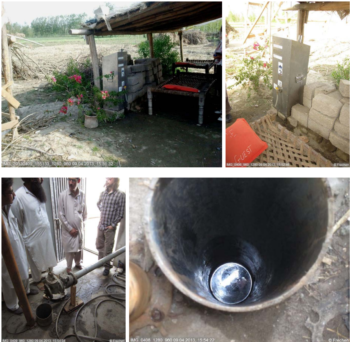
Abbildung 124: Wasserrucksack in Sanger – oben: Ansichten; – unten: Brunnenhaus mit geöffnetem Brunnen (links); Blick in den (am Besuchstag nicht in Betrieb befindlichen) Brunnen (rechts)
