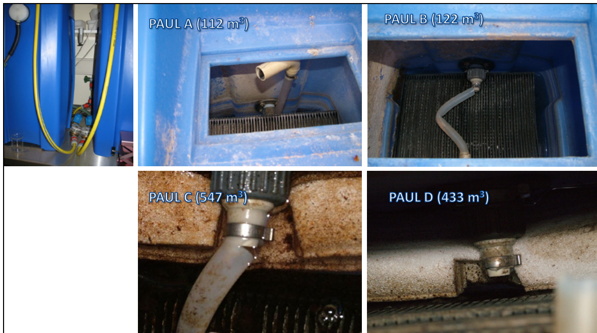
Abbildung 36) Beobachtete Defekte. Oben links: Ausbeulung des Gehäuses. PAUL A: Abgebrochener Membranablauf. PAUL B: Riss am Schlauch an der Befestigung Ablaufhahn. PAUL C: Riss im Schlauch an der Befestigung Ablaufhahn. PAUL D: Abgerissener Schlauch.
