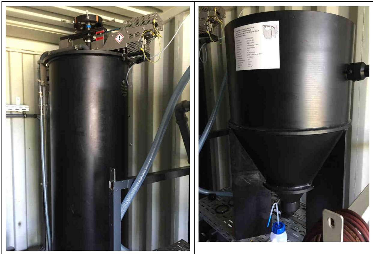
Bild 4-3: Schüttbettfilter (links) mit Nachklärung (rechts) (eigene Aufnahmen)
