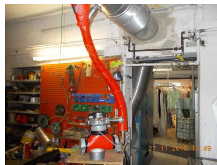
Abbildung 8 Mess-System in der Abluft am 27.11.2015
