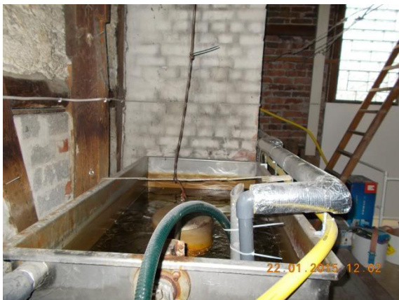
Abbildung 16 Behälter für Kaltwasser im 1. Stock
