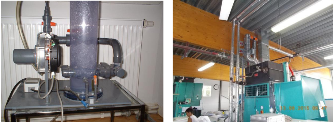
Abbildung 4 Luft gekühlte Wärmepumpe – parallele Zuleitung
