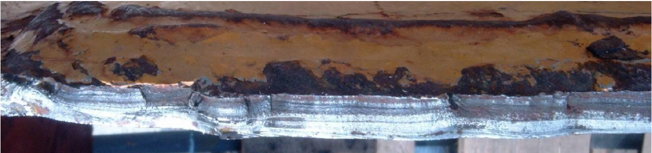
Bild 26: Typischer Dauerbruch im Auslauf der Quer-Schweißnaht
