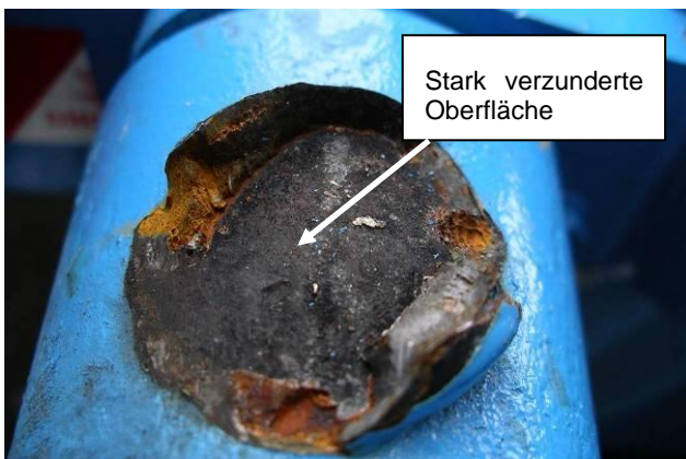
Bild 20: Schweißnaht am Zylinderauge
