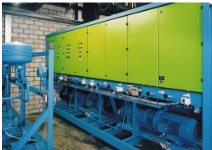
Abb. 12 Tiefkühlsatz und Pumpenstation der NH 3 -Kälteanlage des SB-Warenhauses
