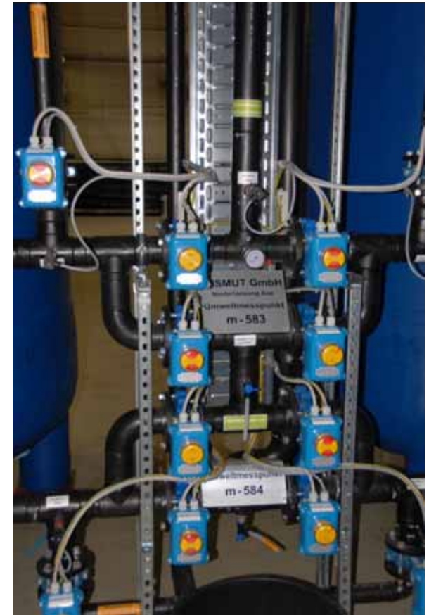
Gesamt- und Teilansicht der Anlage mit den Prozessmesspunkten am Ablauf der beiden Ionenaustauscher
