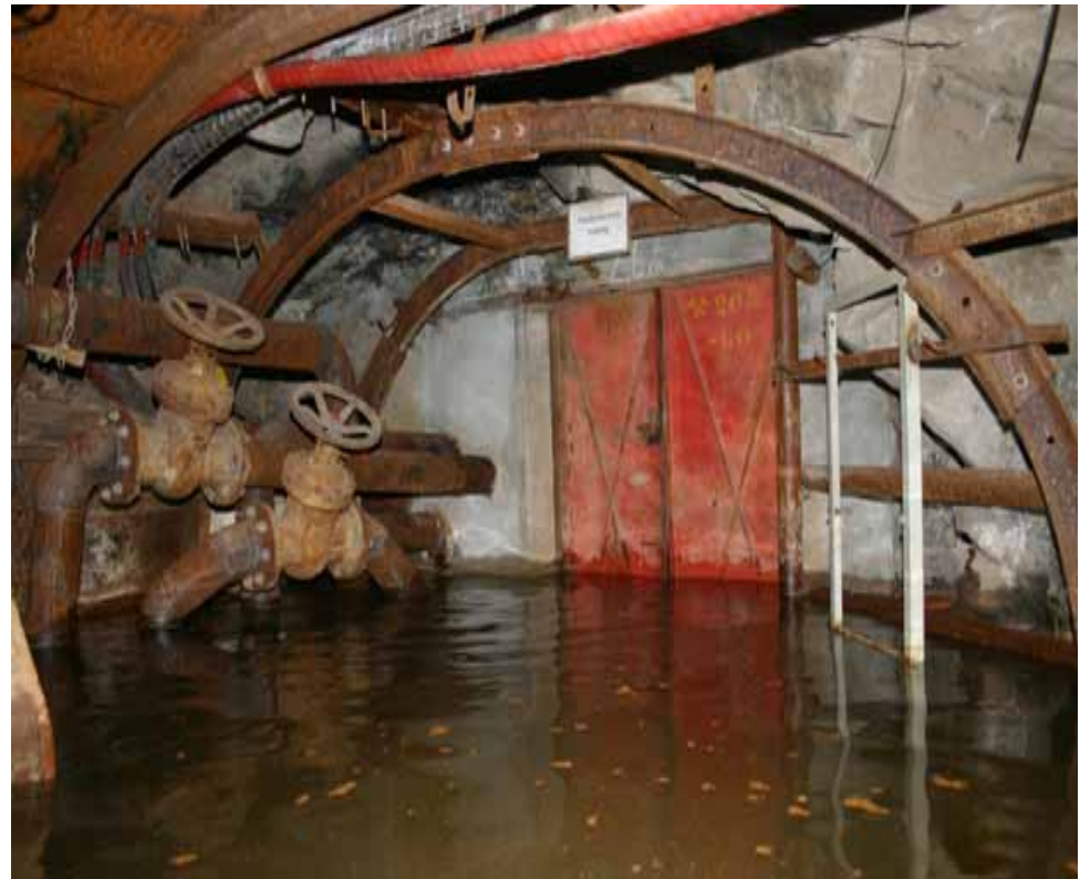
Flutungswasser auf der -60-m-Sohle am Schacht 208
