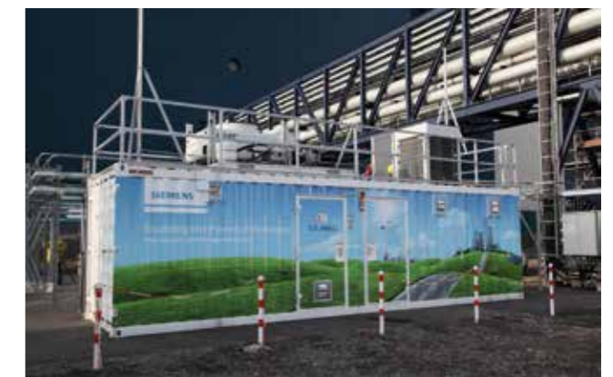
Abbildung 13: PEM-Elektrolyseanlage mit 0,3 MW Spitzenleistung; Betrieb im Rahmen des CO 2 RECT Projekts am Kraftwerksstandort Niederaußem (Siemens Pressebilder)
