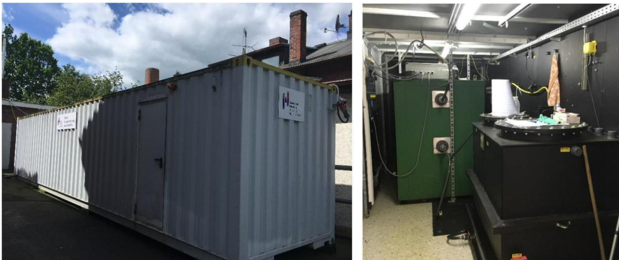
Abbildung 1: Container mit Abwasserreinigungsanlage auf dem Gelände der Meierei Horst (links) mit ABR (grün) und Gärrestlager (schwarz, rechts)
