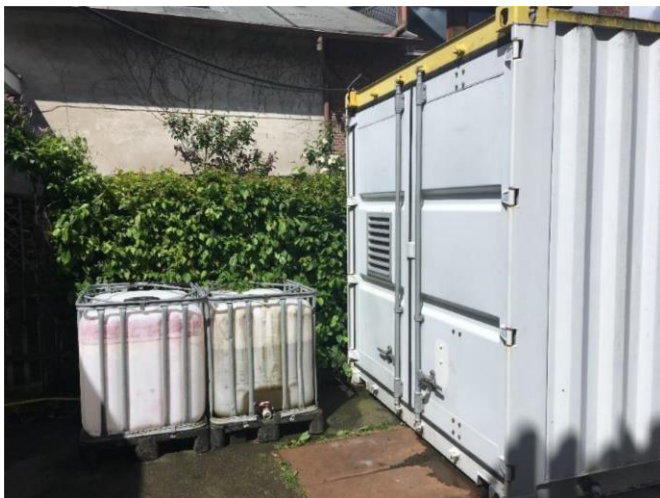
Abbildung 4: IBC mit Substratmischung (links) und Schmutzwasser (rechts) neben dem Container der Abwassereinigungsanlage
