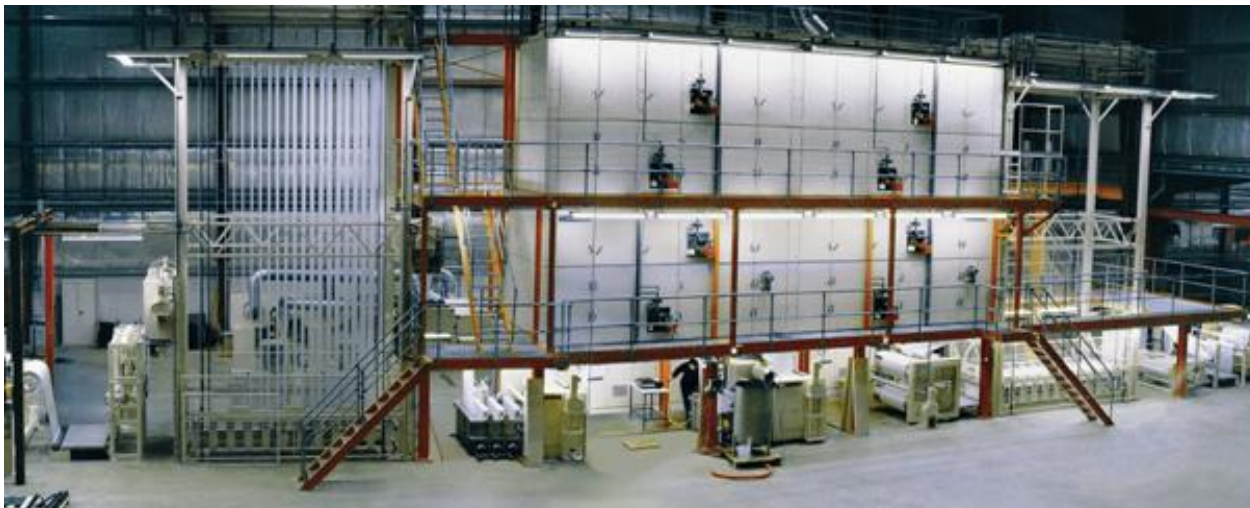
Bild 4: Finishing-Anlage für die Silanausrüstung
