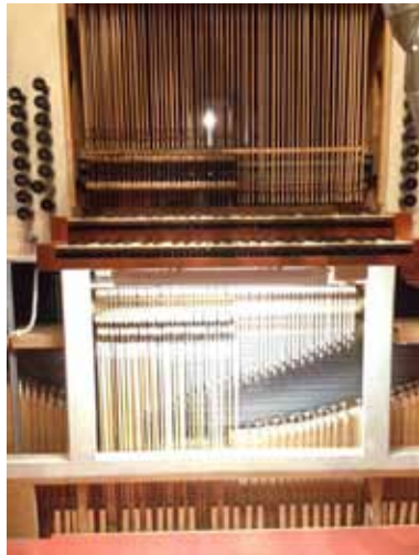
Die Ledermuttern der Schrauben in den Abstrakten (Zugruten) der freigelegten Traktur wurden kontrolliert.
