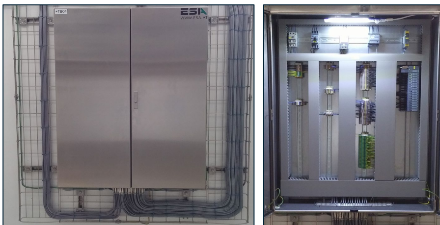
Steuerungsverteiler mit ET200SP Baugruppen:
