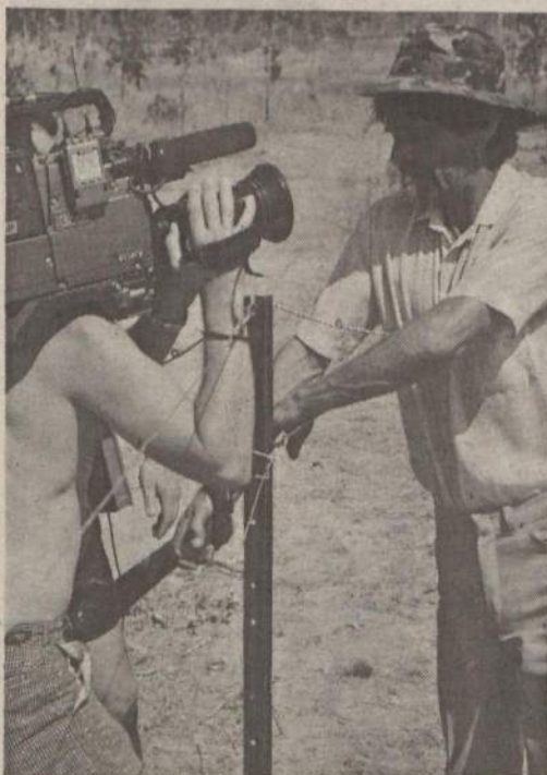
Ein Facharbeiter befestigt die Drähte unter den Augen der Kamera. Der zweitoberste, nach innen geneigte Draht steht unter Strom (aus der Solarzelle).
