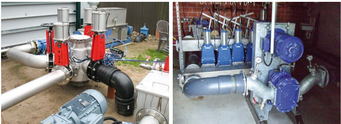
Abb. 3.21: Rohrleitungen und Armaturen in einer Pumpstation, Absperrschieber [PlanET Biogastechnik GmbH (links), FNR/M. Paterson (rechts)]
