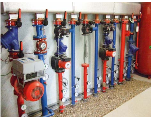
Abb. 6.7: Heizverteiler [FNR/M. Paterson]
