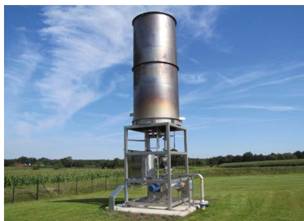
Abb. 3.42: Notfackel einer Biogasanlage [FNR/D. Riesel]
