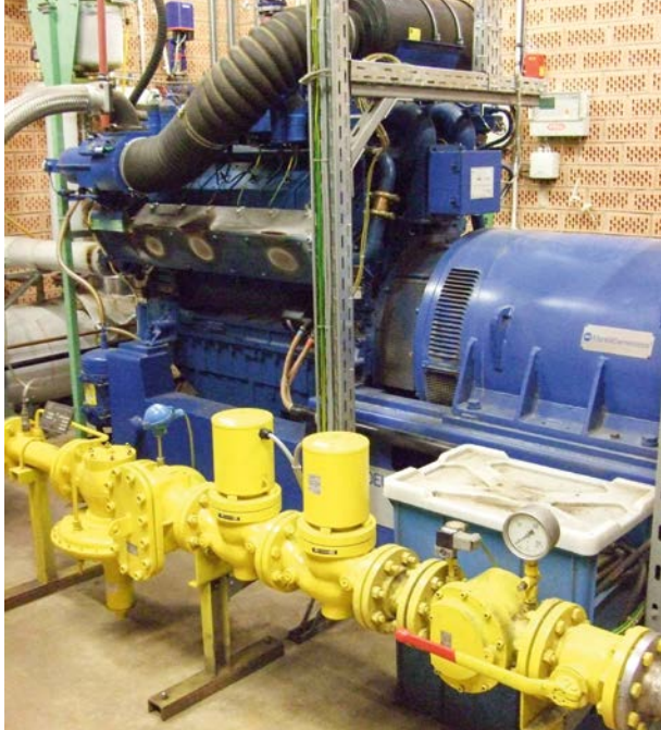
Abb. 6.8: BHKW mit Gasregelstrecke [FNR/M. Paterson]
