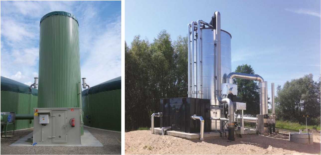
Abb. 6.2: Externe biologische Entschwefelung, links Bio-Rieselbettreaktor, rechts Biofeuchtreaktor [S&H GmbH & Co. Umweltengineering KG]
