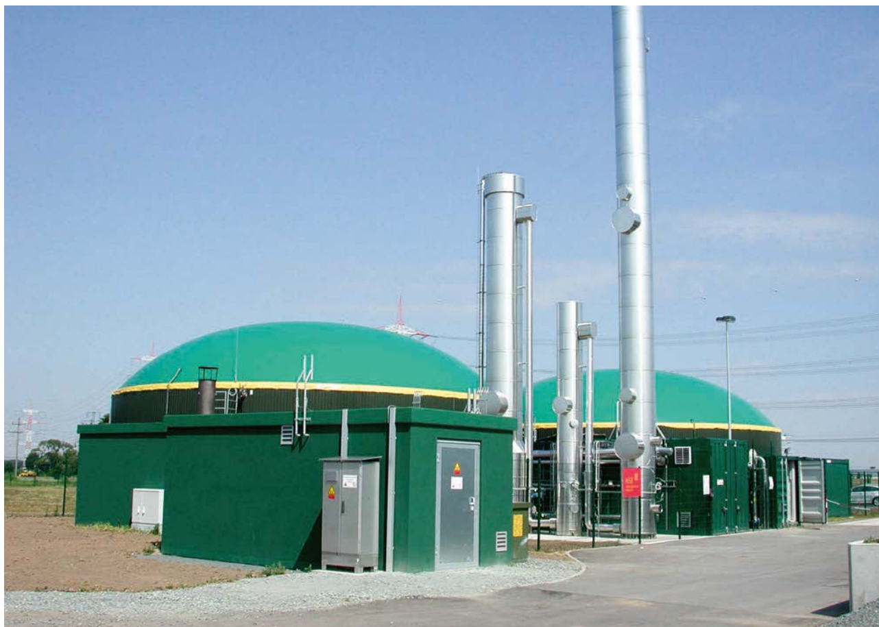
Abb. 6.3: Biogasaufbereitungsanlage (Druckwasserwäsche) in Darmstadt [Fraunhofer IWES/M. Beil]
