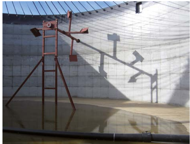
Abb. 3.35: Paddelrührwerk [PlanET Biogastechnik GmbH]
