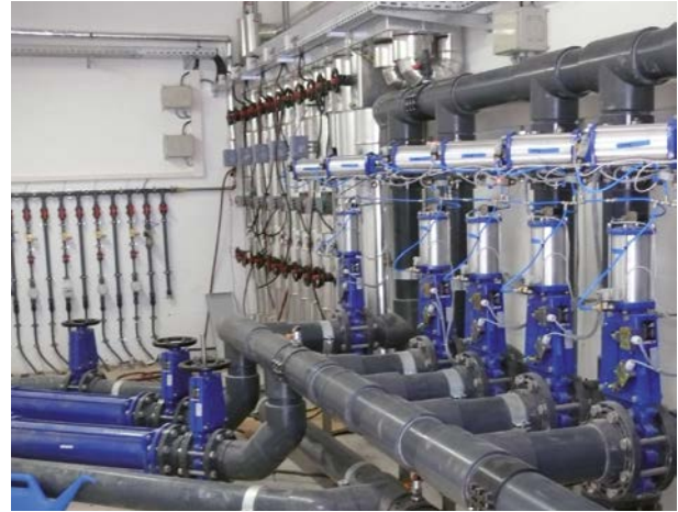
Abb. 3.12: Pumpen in einer Biogasanlage [WELTEC BIOPOWER GmbH]
