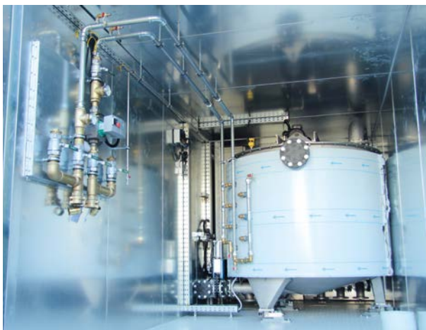
Abb. 3.10: Hygienisierungscontainer [PlanET Biogastechnik GmbH]
