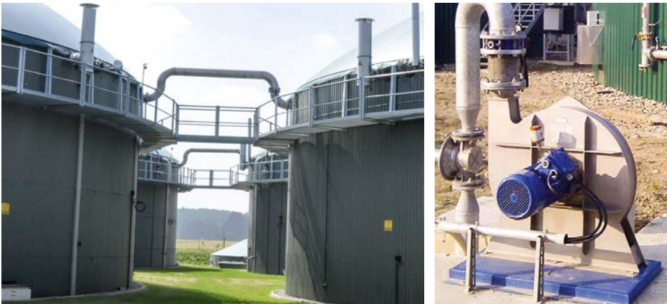
Abb. 3.22: Arbeitsbühnen zwischen Behältern mit Rohrleitungen und Drucksicherungen (links); Gasverdichter (rechts) [MT-Energie GmbH (links), Gastechnik Himmel GmbH (rechts)]
