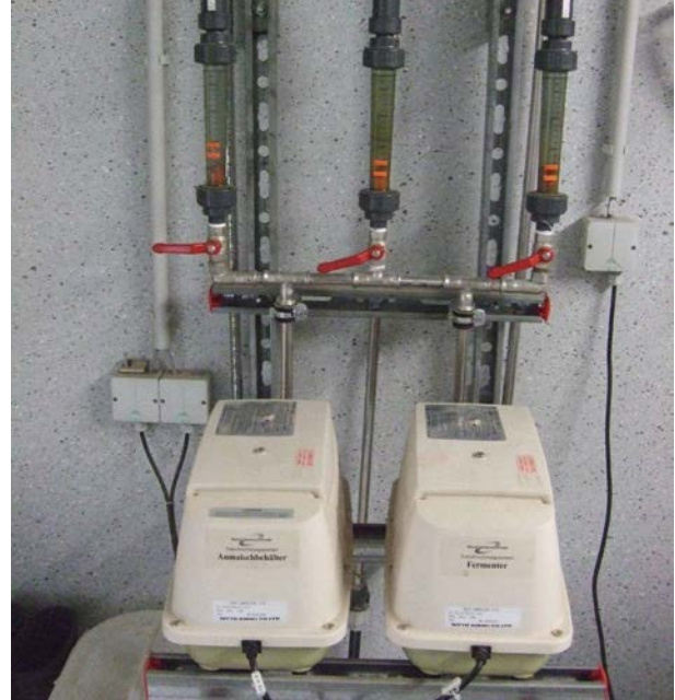
Abb. 6.1: Gasregelung für die Lufteinblasung [FNR/M. Paterson]
